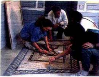
Instalación de un mosaico en la Cámara de Comercio de Alcalá de Henares.
